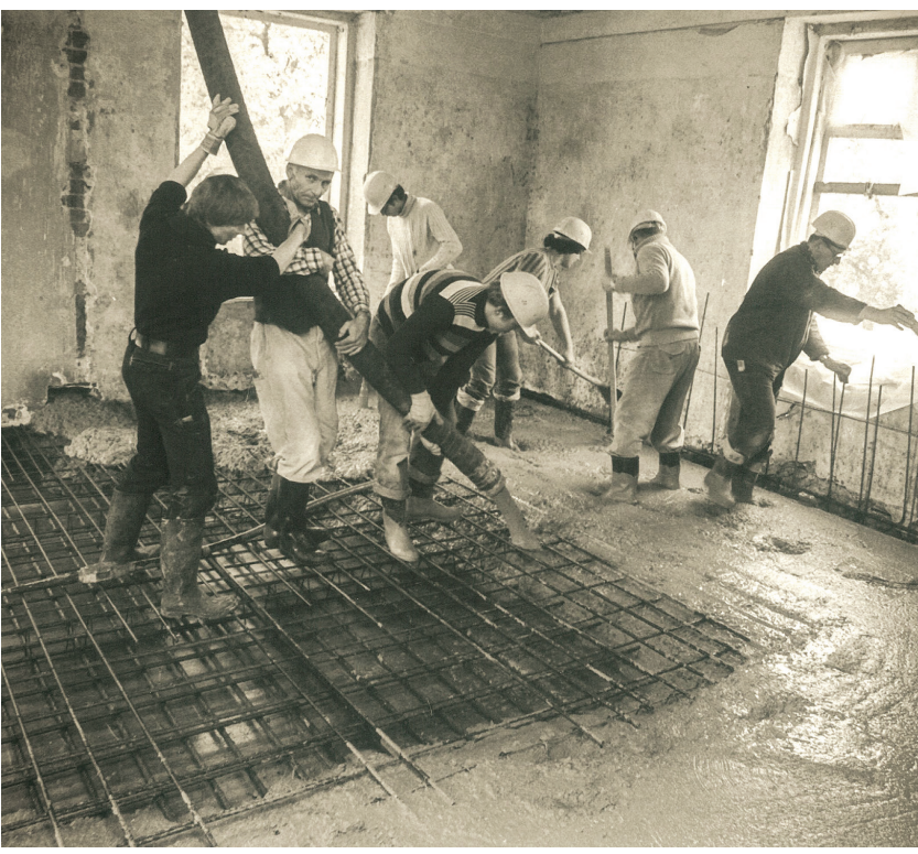
Während der Sanierung wurden in der gesamten Burg tragfähige Zwischendecken für die einzelnen Stockwerke eingebracht. (Foto: Archiv Burg Bederkesa)
