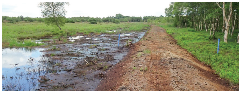
Moorwassermesspegel vor und hinter einer Spundwand – überdeckt durch eine Verwallung im Bereich „Kambeck“ im Ahlenmoor (Foto: L. Kuhlke)
