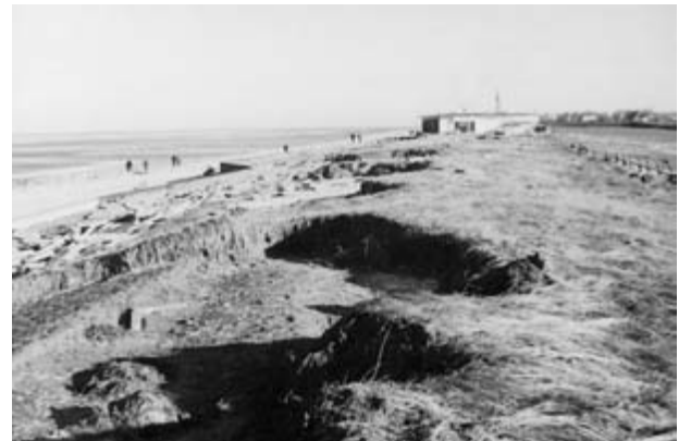
Zerstörter Deich zwischen Döse und Duhnen nach der Sturmflut von 1962
